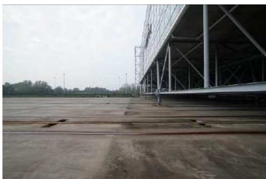
外側から見た引き出し口
