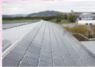
電力を供給するスタジアム屋根のソーラーパネル(ベルン)
